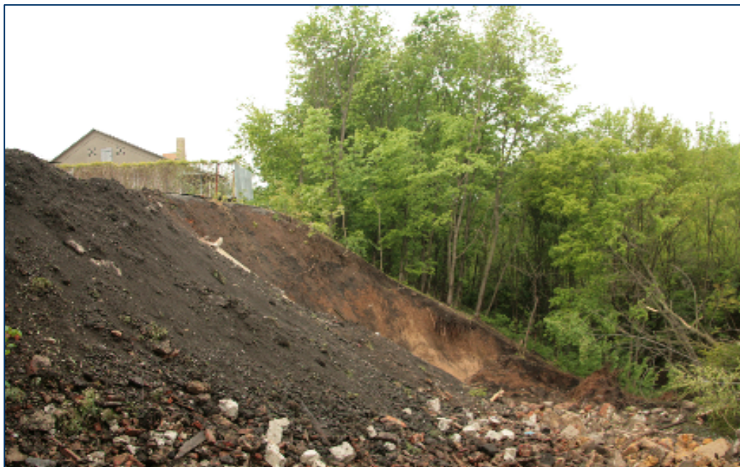
Рис. 4. Оползень па склоне овражно-балочной системы на окраине г. Короча
