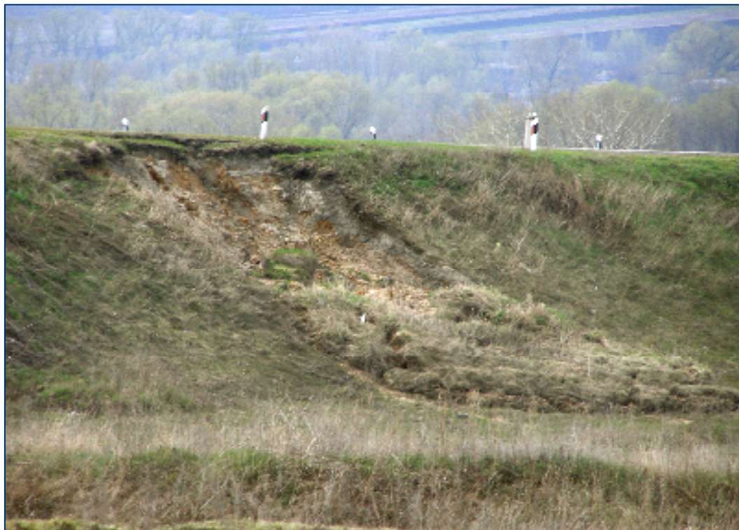
Рис.1. Оползень – поток, поражающий тело автомобильной дороги
