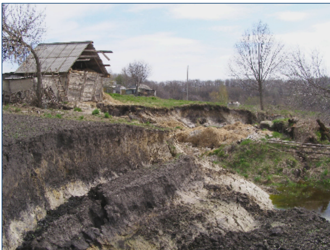
Рис. 5. Разрушение хозяйственных построек оползнем в с Щербаково Алексеевского района
